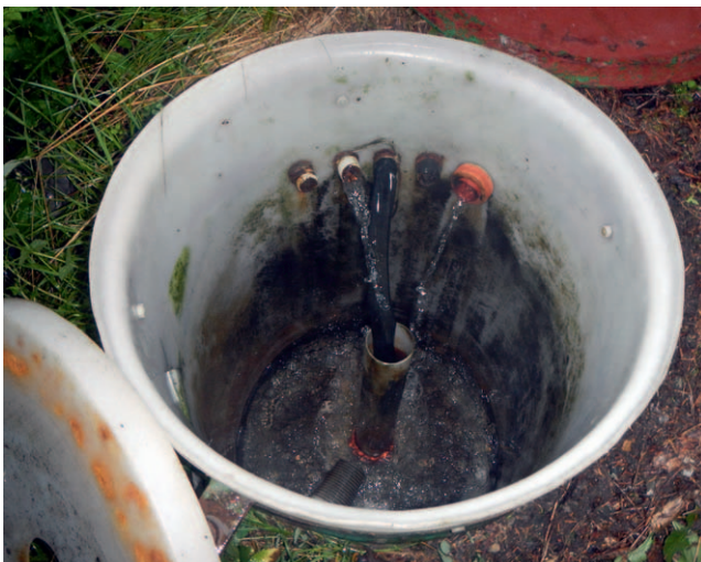
Verunreinigung in der Quelfassung deutlich ersichtlich
