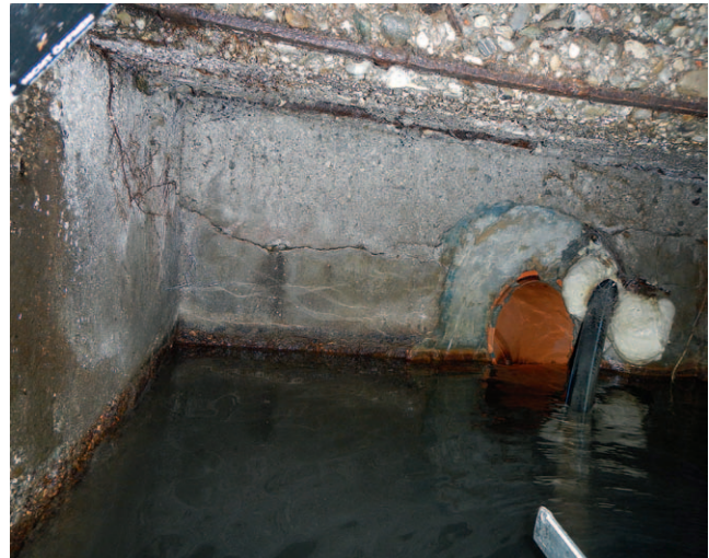
Bauschäden im Hochbehälter
